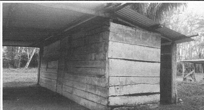
Foto 2: Parte frontal de la cocina con pared de madera podrida
