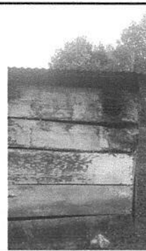
Foto 6: Parte lateral de la cocina con madera rota y podrida
