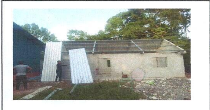
Foto 2: Sustitución de estructura de soporte de madera por metal de la cocina.
