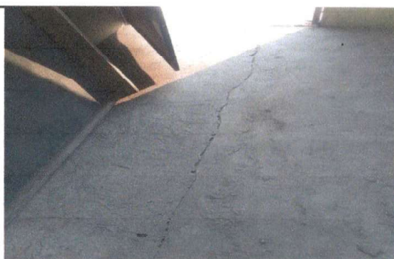
Foto 4: Piso no apto para caminar sobre él.
