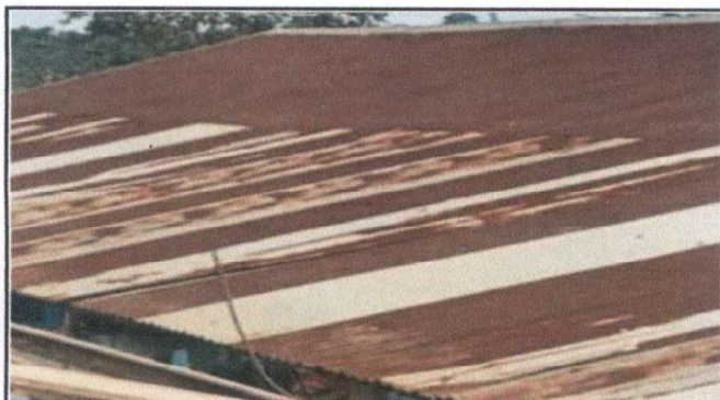
Foto 3: Láminas en muy mal estado.
