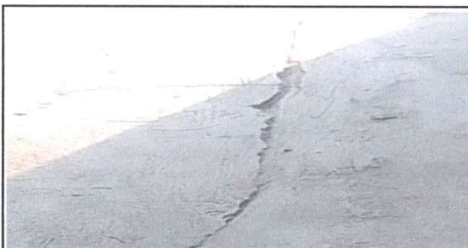
Foto 5: Piso quebrado y muy peligroso.
