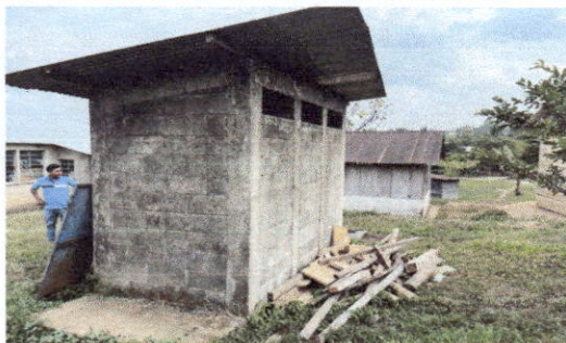
Foto 9: MUROS DE SANITARIOS DETERIORADOS, REQUIRIENDO DE UN REMOZAMIENTO GENERAL DE LOS MISMOS.
