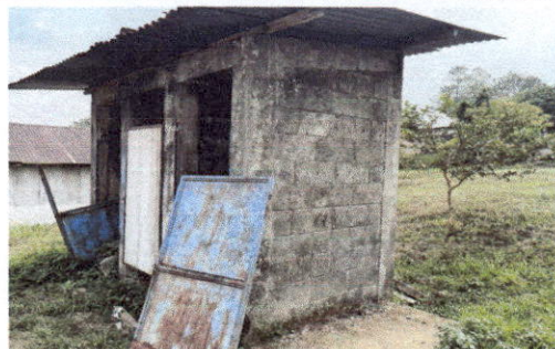
Foto 10: TECHO Y PUERTAS DE SANITARIOS, COMPLETAMENTE DETERIORADAS.
