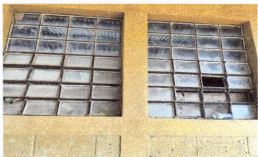
Foto 7: VENTANERIA ACTUAL, EN MALAS CONDICIONES.
