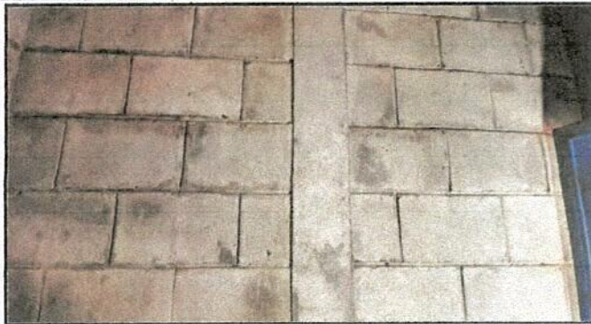
Foto 7: Repello en muro de aulas
