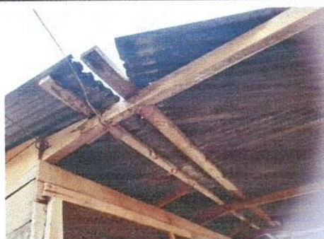
Foto 6: Estructura de lamina en mal estado.
