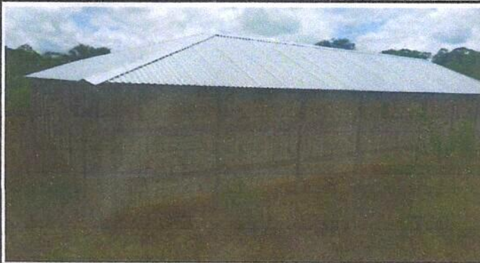
Foto 1: Vista general de la parte externa del centro educativo, tomada del ángulo sur. (Techado)
