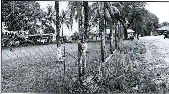
Foto 1: Reparación de muro perimetral de block con tubo hg y malla galvanizada, soleras intermedias y columnas.
