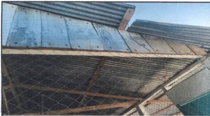
Foto 3: Mayas de ventanas en mal estado
