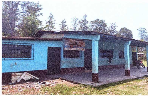
MODULO 1. sustitucion de lamina troqueleda y estructuras metálicas, sustitución de piso cerámico
