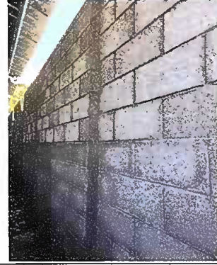
Foto 2: Parte de atrás del muro perimetral.
