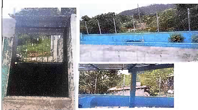
Foto 3: Modulo1: Mantenimiento de porton de metal, reparación de muro perimetral de block con tubo de HG, Maya y solera intermedia.
