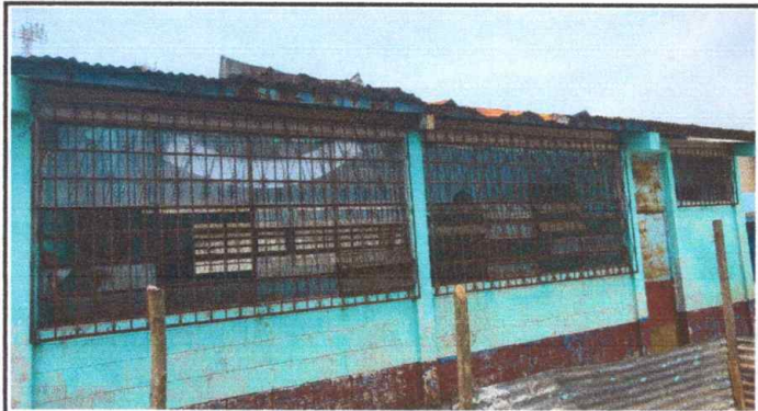
Foto 3: MODULO 1 Sustitución de la lamina por lamina troquelada aluzinc y de la estructura de metal. Mantenimiento de los balcones, ventanales y puertas. Sustitución de vidrios.
