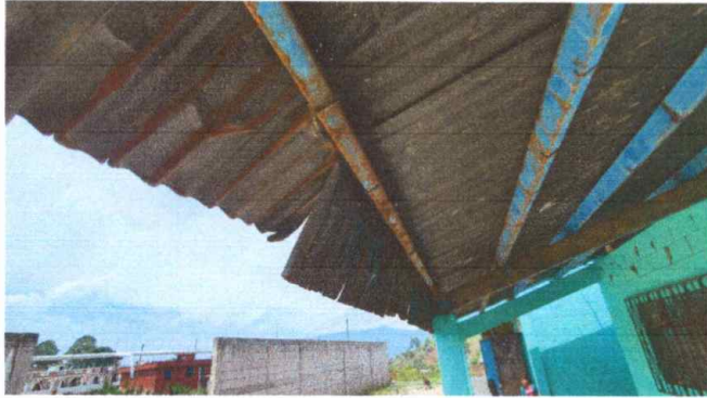
Foto1: MODULO 2 Sustitución de la lamina por lamina troquelada aluzinc y de la estructura de metal.
