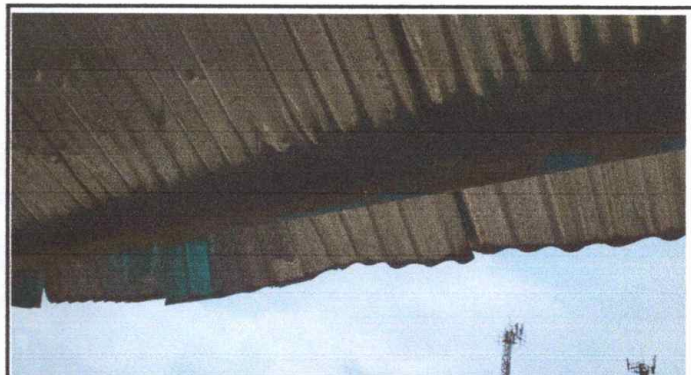
Foto 4: MODULO 1 Sustitución de la lamina por lamina troquelada aluzinc y de la estructura de metal.
