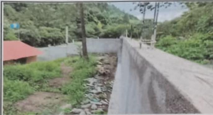
Foto 1: Condiciones de muro de contención que se encuentra a un costado del establecimiento.
