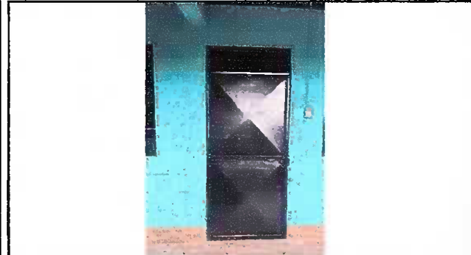
Foto 1: Modulo 1. Mantenimiento a estructura de puerta (lijado, cambio de tubo, cepillado, sujecciones, aplicación de pintura).
