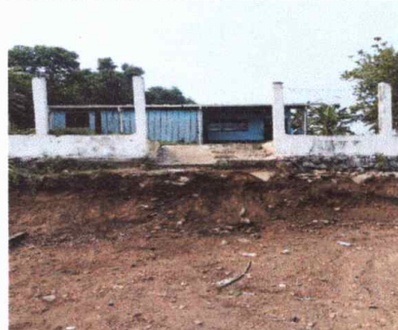
Foto 4: MURO PERIMETRAL REPARACION DE PISO DE ENTRADA Y PORTON DE INGRESO
