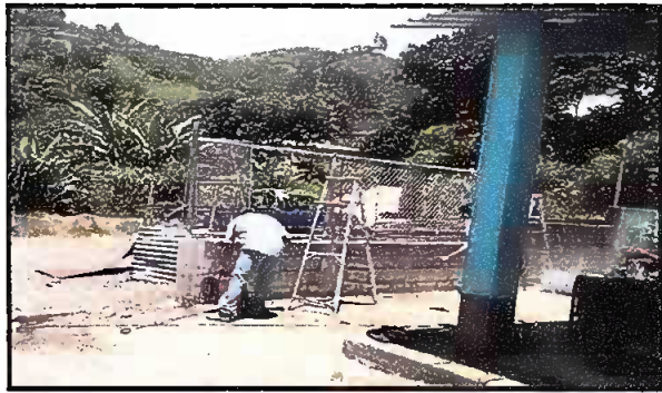
Foto 9: MURO PERIMETRAL Reparación de muro perimetral de block con tubo hg y malla galvanizada, soleras intermedias y columnas.
