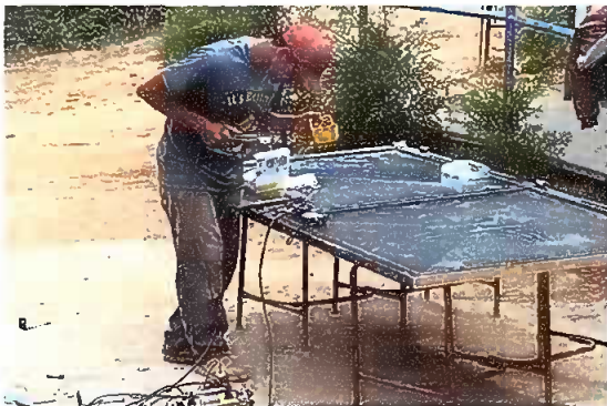
Foto 1: Mantenimiento a estructura de puertas (lijado, sujeciones y aplicación de pintura), Sustitución de chapas; durante la acción.
