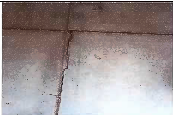
Foto 3: Sustitución de piso de torta de concreto a piso de granito, antes de la acción.
