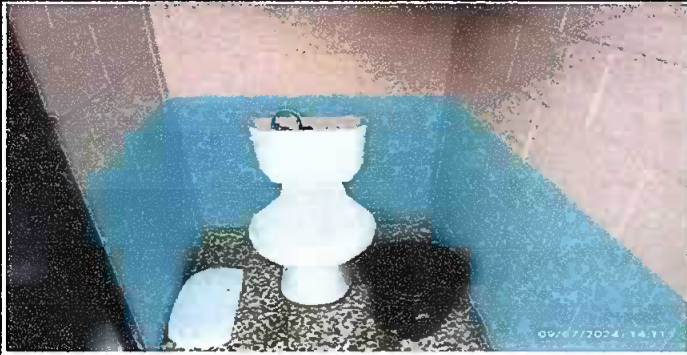
Foto13: SUSTITUCIÓN DE ACCESORIOS DE INODORO(CONTRA LEVE, TUBO DE ABASTO Y TANQUE). MODULO IV.
