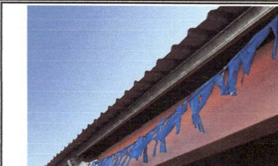
Foto 2: TECHO DE LAMINA SIN CANAL Y BAJADA DE AGUA EN AREA DE CORREDORES.
