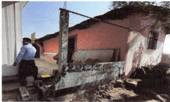
Foto 9: MURO PERIMETRAL ANEXO A LA COCINA, DAÑADO Y CON FALTA DE SEGURIDAD PARA LOS ALUMNOS
