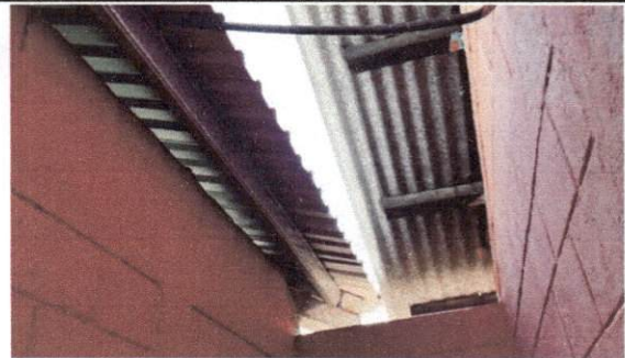
Foto 8: SECTOR DEL TECHO DE LA COCINA, SIN CUBRIR COMPLETAMENTE.
