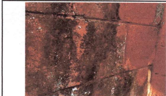
Foto 5: PINTURA Y MURO DETERIORADO EN ARERA DE SANITARIOS.
