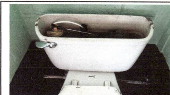
Foto 4: INODORO, INCOMPLETO Y QUEBRADO EN LA PARTE DEL TANQUE.
