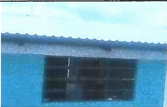
Foto 5: Sustitucion de Capote
