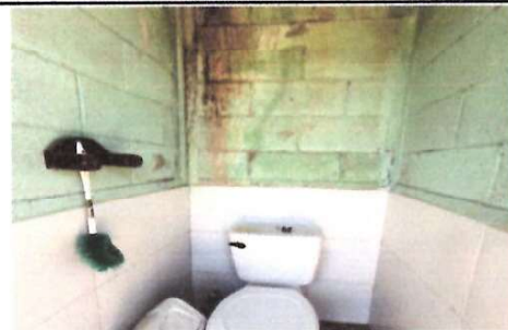
Foto 6: PINTURA DE MUROS INTERIORES Y EXTERIORES DE SANITARIOS EN MAL ESTADO
