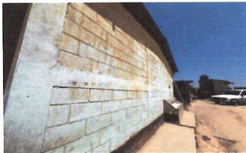
Foto 3: PINTURA POSTERIOR DEL MODULO, EN MAL ESTADO.
