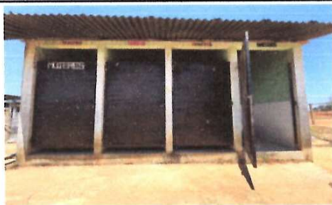
Foto 5: PUERTAS DE METAL DE SANITARIOS SIN MANTENIMIENTO Y MARCOS CAIDOS.
