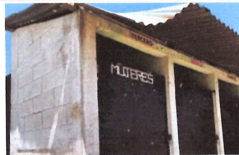
Foto 4: TECHO DE LAMINA Y ESTRUCTURA DE SANITARIOS DAÑADA.
