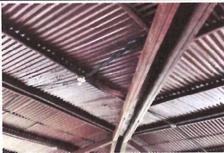
Foto 1: AREAS DE LAMINA DEL TECHO ACTUAL DETERIORADO.
