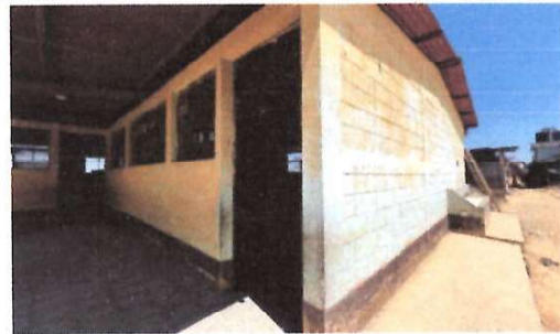
Foto 2: PINTURA DE INTERIOR Y EXTERIOR DETERIORADA DEL MODULO DE AULAS, DETERIORADA.
