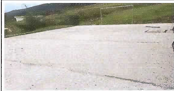
Foto 1: Necesidad de reparación de la torta de cemento
