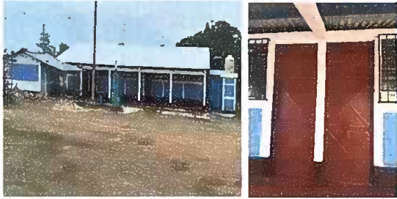
Foto 1: Sustitución de láminas, por lámina troquelada aluzinc calibre 26, capote, mantenimiento a estructura de soporte de metal y puerta
