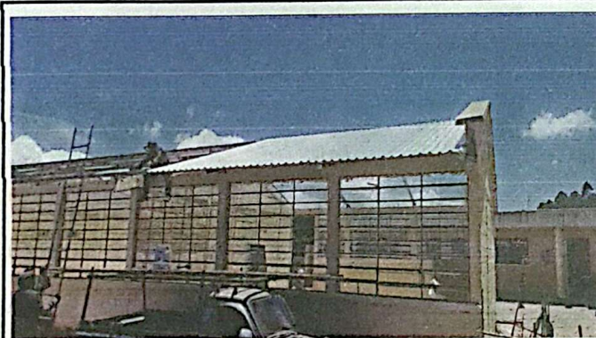
Instalación de estructura de soporte de metal e instalación de lámina troqueladas de aluzinc calibre 26
