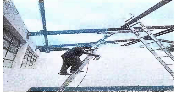
Foto 2: Módulo 1 Suttitucion de cableado, Suttitucion de focos ahorradores , suttitucion de plafoneras y mantenimiento de costaneras
