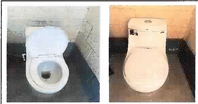
Foto 5: Inodoros instalados del módulo tres.
