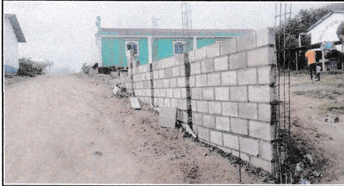
Foto 1: Reparación de muro perimetral de bloques con tubo de hierro y malla galvanizada, soleras intermedias y columnas.
