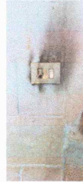
Foto 4: Modulo 1 y 2: sustituir cables de la Electricidad.
