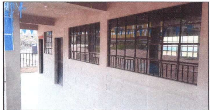
Foto 6: MODULO 1. Aulas sin balcones de metal.
