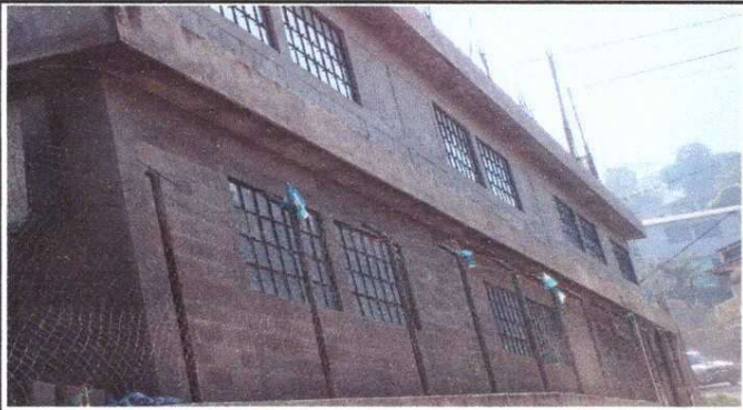
Foto 1: PINTURA GENERAL. Muros exteriores sin pintura.
