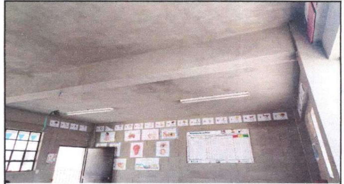
Foto 2: PINTURA GENERAL. Muros interiores de las aulas sin pintura
