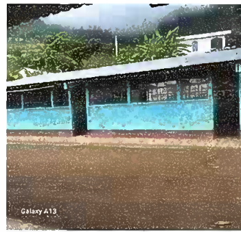
Foto 4, Módulo 2: Sustrucción de vidrios y balcones
