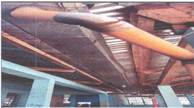
Foto: 5 Canales en mal estado cambio
