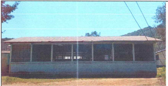
Foto : 6 Canales en mal estado
