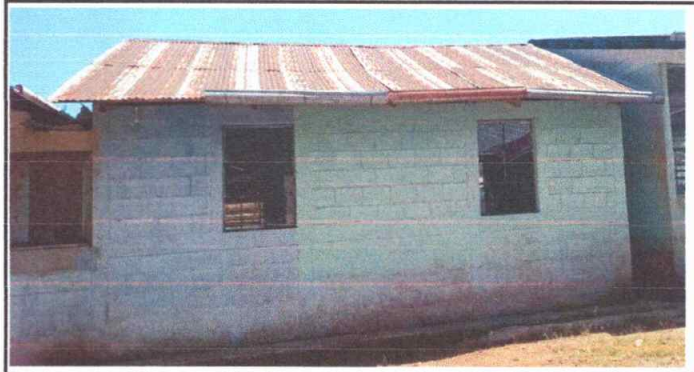
Foto: 4 Techo en mal estado
