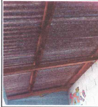
Foto : 2 Aula, vigas en mal estado.
