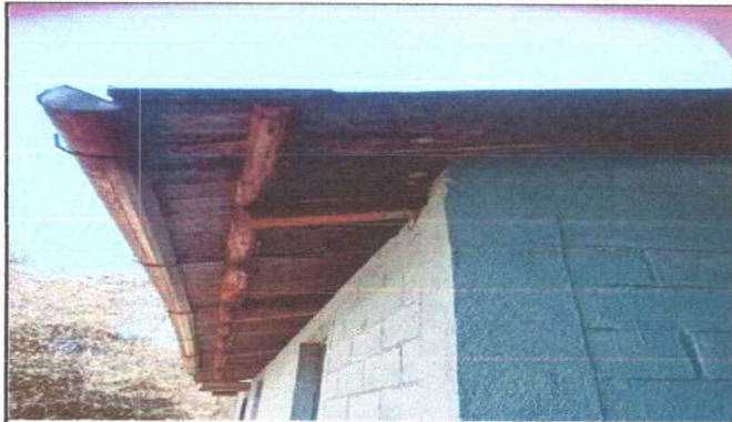
Foto 1: Aula, vigas en mal estado.
