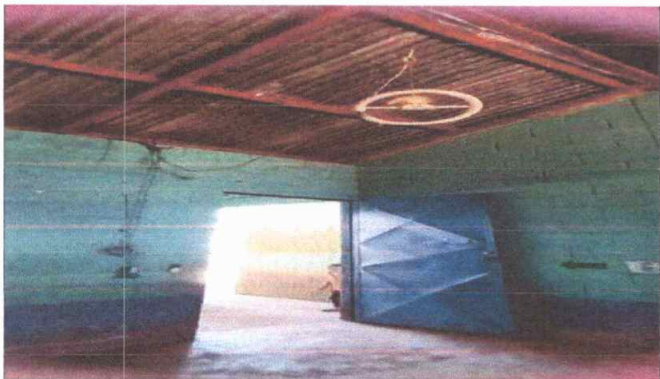
Foto : 3 Cableado en mal estado
