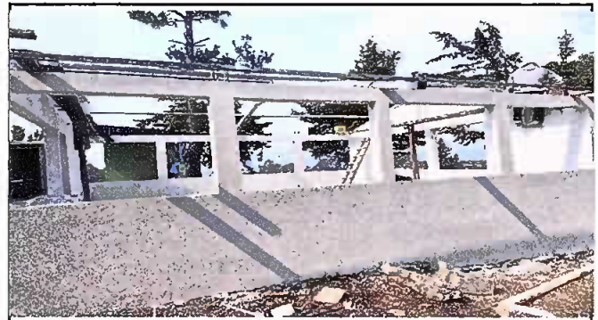
Foto 2: Paredes de cocina incompletas.
