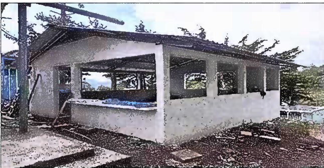
Foto 5: Cocina, techo en mal estado.
