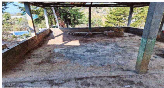
Foto 3: Piso de cocina mal estado.
