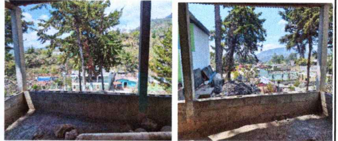
Foto 2: Paredes de cocina incompletas.
