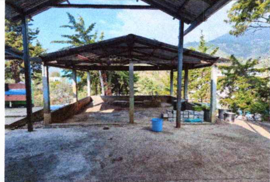
Foto 4: Cocina en mal estado.
