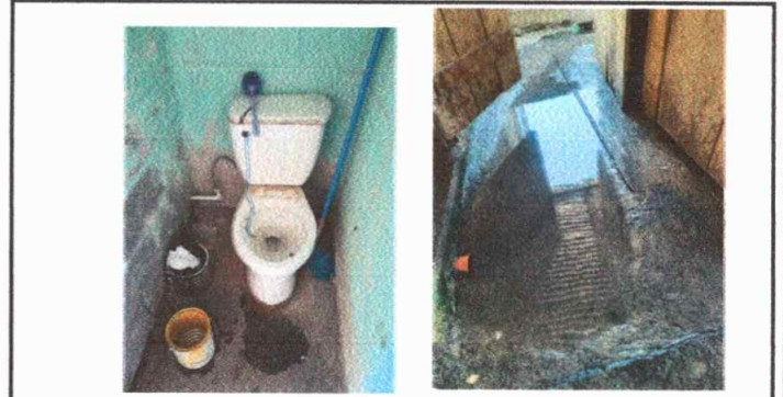
Foto2: tazas y drenaje en mal estado.
