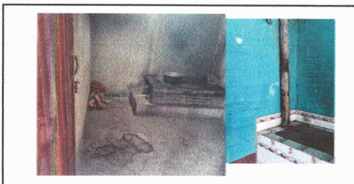
Foto3. Chimeneas en mal estado y sustitucion de piso de torta.
