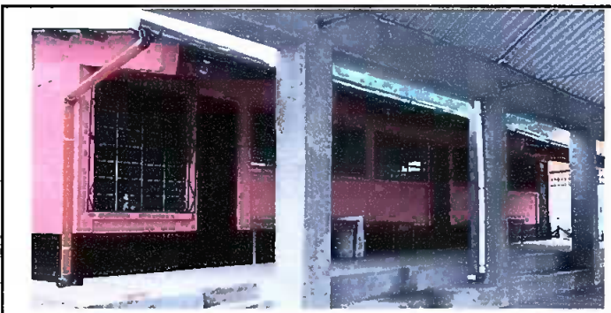
Sustitución de cableado eléctrico, sustitución de canales, sustitución de bombillas led y pintura de aulas
