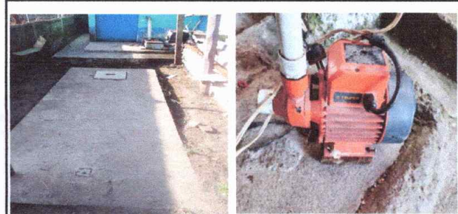
Foto No.5. Cisterna y bomba de agua en mal estado.
