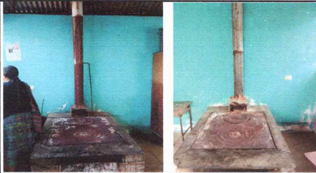
Foto No. 7. Cocina Escolar. Plancha de cocina en mal estado
