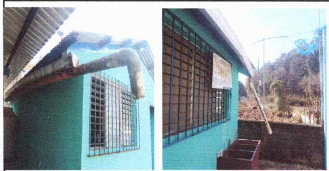
Foto No.4. bajadas de agua en la escuela en mal estado.
