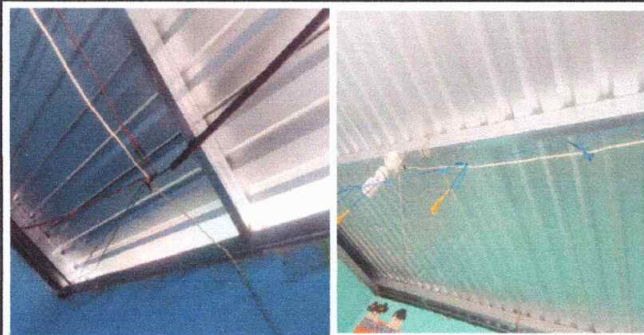
Foto No.5. Cable y accesorios de energia electrica en mal estado
