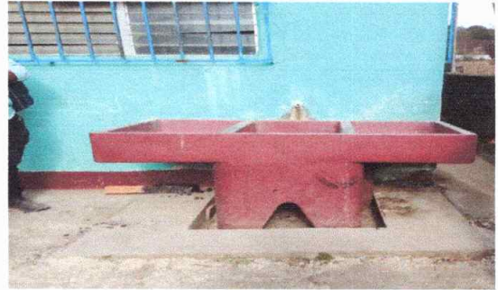
Foto No.8. Cocina Escolar. Pila en mal estado.
