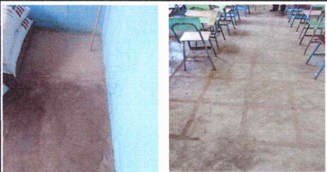
Foto No.3. Bodega y auala 2. Piso en mal estado
