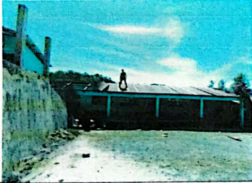
Foto 1: Situación techo remosando edificio dos parte baja.
