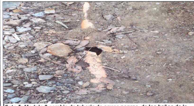
Foto 5: Modulo 3 cambio de tubería de aguas negras, de los baños de la escuela, a la fosa séptica
