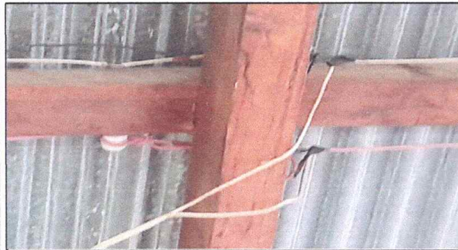
Foto 3: Modulo 2 cambio de instalación eléctrica donde se va a cambiar el techo
