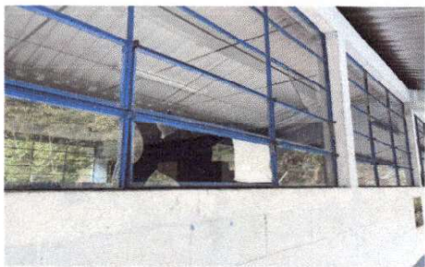
Foto 5: VENTANERIA DE AULAS, CON VIDRIOS DAÑADOS O FALTANTES.
