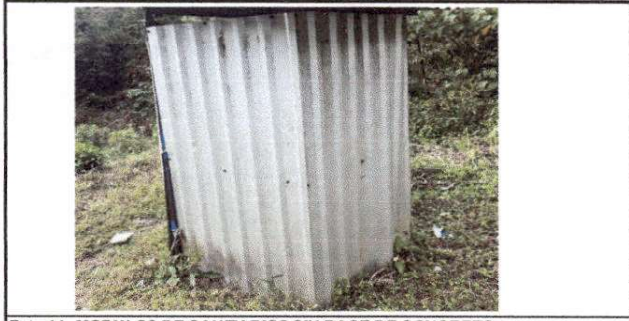
Foto 11: MODULOS DE SANITARIOS SIN BASE DE CONCRETO.
