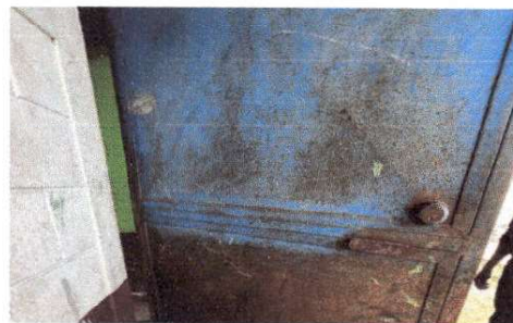
Foto 4: REMOZAMIENTO DE PUERTAS DE METAL REQUERIDO.
