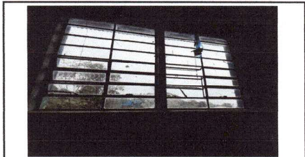
Foto 4: ESTRUCTURAS DE METAL DE LAS VENTANAS EN MALAS CONDICIONES.
