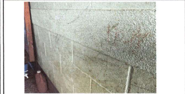
Foto1: PINTURA INTERIOR DE AULAS DETERIORADA.
