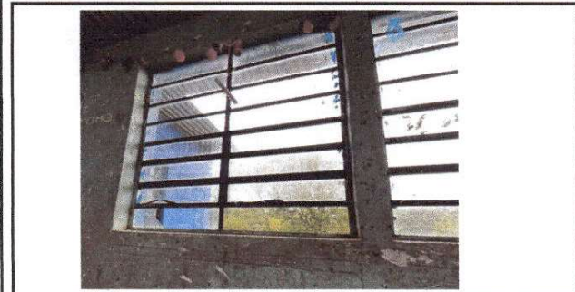
Foto 3: VENTANAS SIN VIDRIOS Y VIDRIOS QUEBRADOS.
