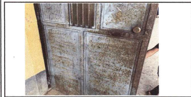
Foto 5: PUERTAS DE AULAS CON PINTURA TOTALMENTE DETERIORADA.
