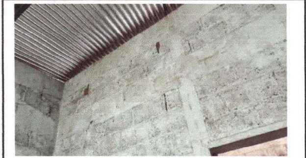
Foto 2: PINTURA APLICADA DE BAJA CALIDAD Y SIN MANTENIMIENTO.
