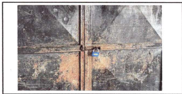
Foto 6: PORTON PRINCIPAL EN MAL ESTADO Y SIN CHAPA.
