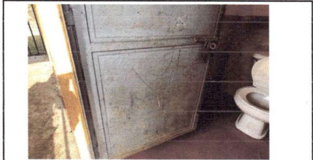
Foto 7: PUERTAS DE SANITARIOS EN MAL ESTADO.
