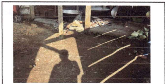
Foto 9: ACTUALMENTE LA COCINA NO CUENTA CON PISO FIRME, SIENDO ESTE DE TIERRA.
