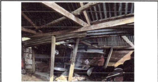
Foto 8: CONDICIONES DE LA COCINA Y SU ESTRUCTURA PORTANTE DE MADERA YA DETERIORADAS.
