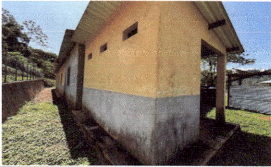
Foto 3: PINTURA EXTERIOR EN GENERAL, EN MAL ESTADO.
