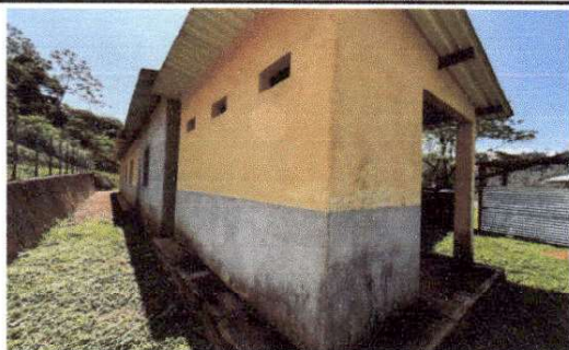
Foto 3: PINTURA EXTERIOR EN GENERAL, EN MAL ESTADO.
