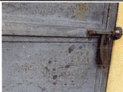
Foto 8: PUERTAS DE SANITARIOS MANCHADAS Y OXIDADAS.
