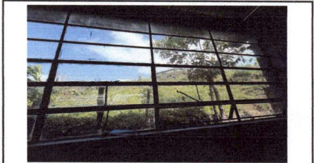
Foto 2: VIDRIOS QUEBRADOS O MODULOS SIN VIDRIOS.
