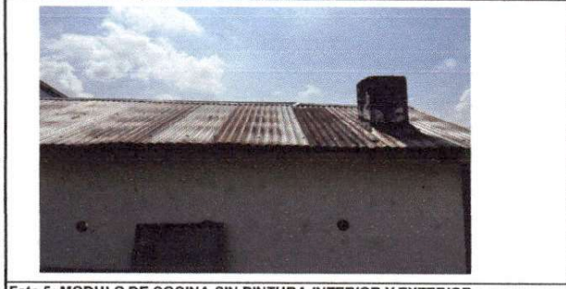
Foto 5: MODULO DE COCINA SIN PINTURA INTERIOR Y EXTERIOR.
