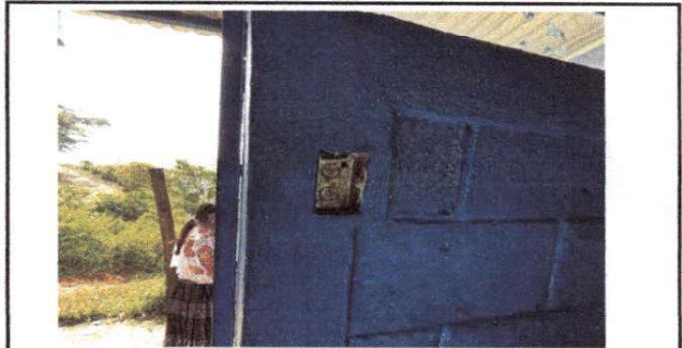
Foto 4: AULAS SIN INSTALACIONES ELECTRICAS.
