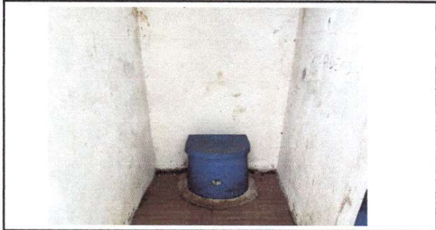
Foto 7: MODULO DE SANITARIOS SIN PINTURA INTERIOR Y EXTERIOR.
