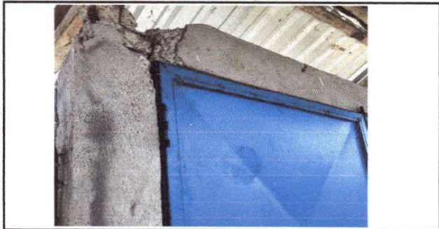
Foto 9: ESTRUCTURA DEL MARCO PRINCIPAL DEL PORTON, DETERIORADO.
