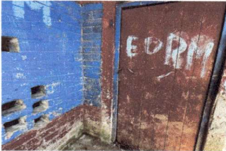
Foto 7: LAS PUERTAS SON DE MADERA EN MAL ESTADO.
