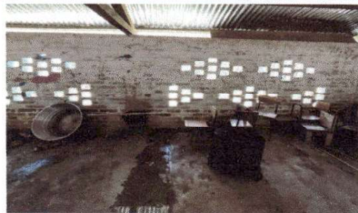
Foto 6: NO SE CUENTA CON LA VENTILACION ADECUADA PARA EL USO ACTUAL DEL ESPACIO.
