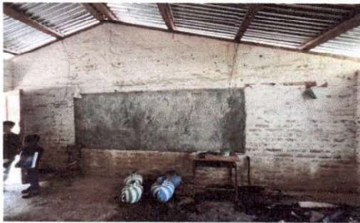
Foto 9: AL IGUAL QUE EL EXTERIOR, EL INTERIOR NO CUENTA CON NINGUN REPELLO EN MUROS.
