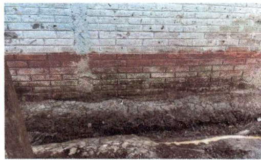
Foto 4: PINTURA EXTERIOR EN MAL ESTADO Y SIN MANTENIMIENTO DE MUROS.
