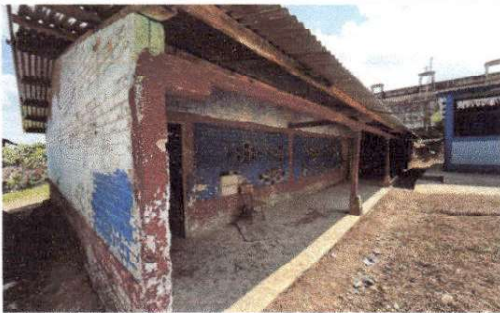
Foto 3: MODULO ANTIGUO YA DETERIORADO.
