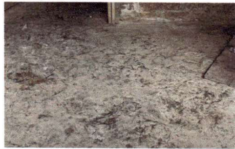
Foto 10: EL PISO DEL MODULO ESTA EN MAL ESTADO, DEBERIA REMOZARSE.
