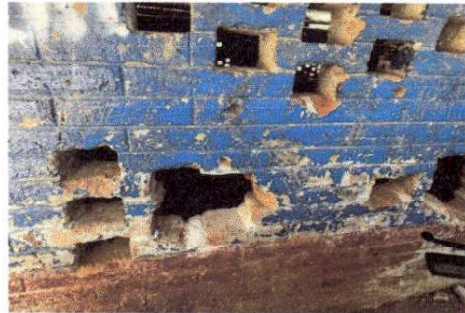
Foto 8: SE APROVECHARA EL DETERIORO DE MUROS PARA TRABAJAR VANOS DE VENTANAS PARA MAYOR ILUMINACION Y VENTILACION.
