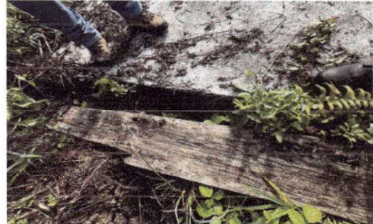
Foto 8: ACTUALMENTE HAY CAJA PARA COLOCACION DE FOSA SEPTICA, PERO NO SE CUENTA CON UNA, DEJANDO SIN USO LOS SANITARIOS.
