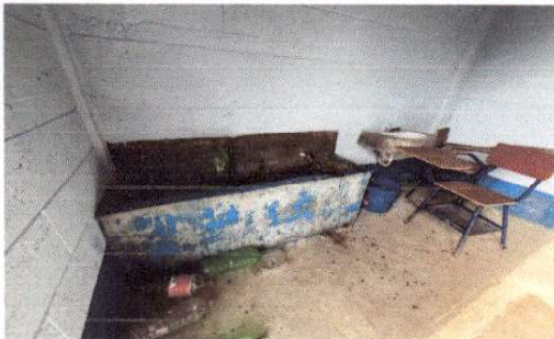
Foto 9: MINGITORIO DETERIORADO POR HUMEDAD.
