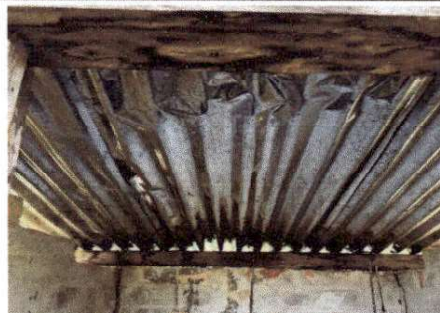
Foto 10: LAMINA DEL SANITARIO DE CALIBRE MUY DELGADO Y DETERIORADA.
