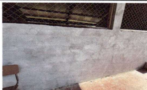
Foto 4: MÓDULO DE AULA, SIN NINGUNA APLICACIÓN DE PINTURA INTERIOR O EXTERIOR.
