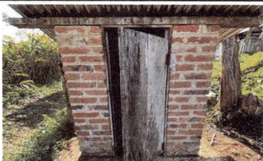
Foto 9: PAREDES DEL SANITARIO SIN REPELLO Y PUERTA DE MADERA TOTALMENTE ARRUINADA.
