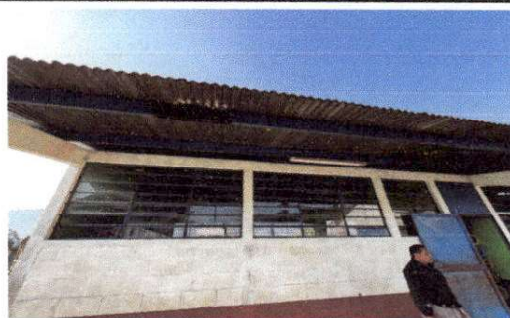
Foto 2: PROBLEMAS DE EMPOZAMIENTO DE AGUA EN CORREDOR PRINCIPAL, A FALTA DE CANAL DEL TECHO.
