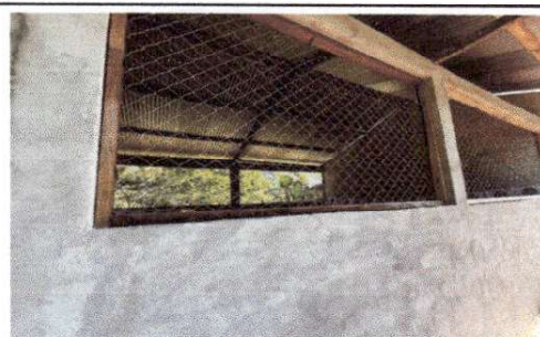
Foto 6: IMPROVISACIÓN DE VENTANAS DE AULA CON MALLA Y MADERA, A FALTA DE ESTRUCTURA DE VENTANAS FORMAL.
