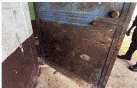
Foto 3: PUERTAS DE AULAS YA DETERIORADAS Y OXIDADAS POR FALTA DE MANTENIMIENTO.
