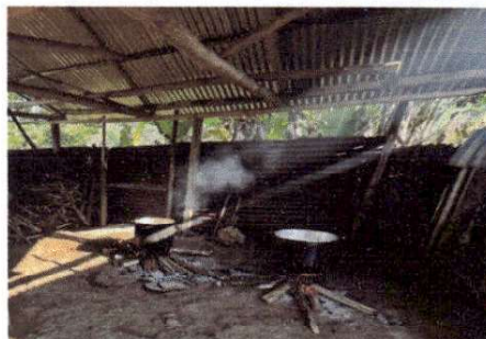
Foto 8: LA CUBIERTA DE LA COCINA SE ENCUENTRA EN MAL ESTADO CON FALLAS EN LOS TRASLAPES Y ORIFICIOS EN LAS MISMAS
