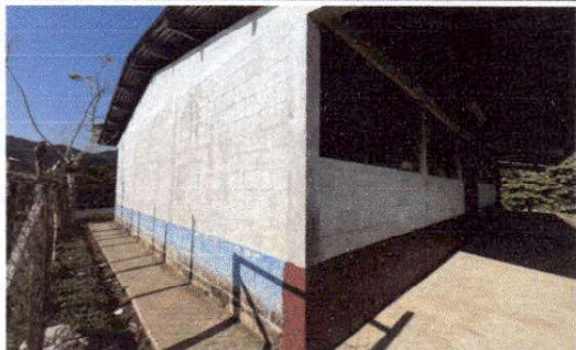
Foto 1: FALTA DE MANTENIMIENTO DE PINTURA EXTERIOR EN MÓDULO DE AULAS
