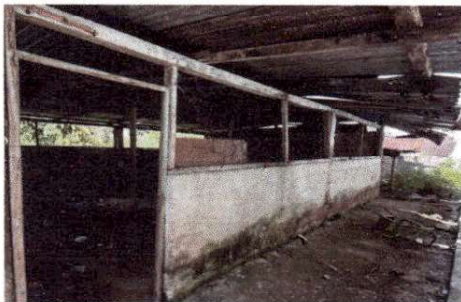
Foto 1: AULA EN MALAS CONDICIONES ABANDONADA.
