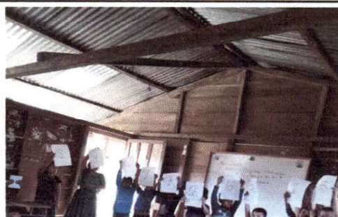
Foto 10: LA LAMINA Y ESTRUCTURA DEL TECHO DETERIORADAS.
