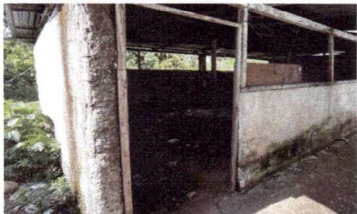
Foto 7: LAS PUERTAS SON DE MADERA EN MAL ESTADO.
