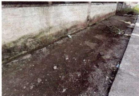
Foto 2: CORREDOR Y ALREDEDORES DEL MODULO SIN PISO.
