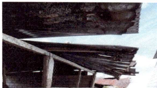
Foto 4: LAMINAS DEL TECHO DEL SALON, TOTALMENTE ARRUINADAS.
