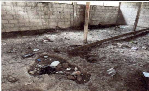
Foto 3: EL INTERIOR DEL AULA NO CUENTA CON UNA TORTA DE CONCRETO DE BASE.
