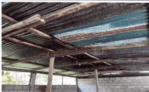
Foto 5: ESTRUCTURA DE TECHO DETERIORADA Y PELIGROSAMENTE CAIDA.
