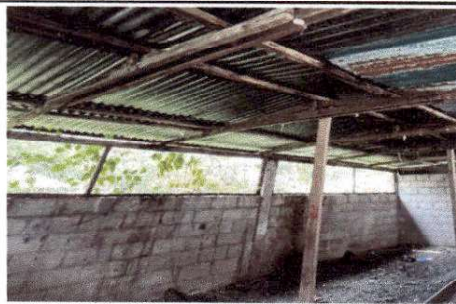
Foto 6: NO SE CUENTA CON VENTANERIA ALGUNA EN EL ESPACIO.
