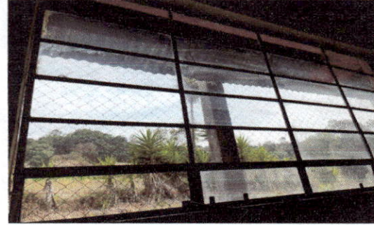
Foto 2: FALTA DE VIDRIOS O QUEBRADOS DE VENTANERIA DE LAS AULAS.
