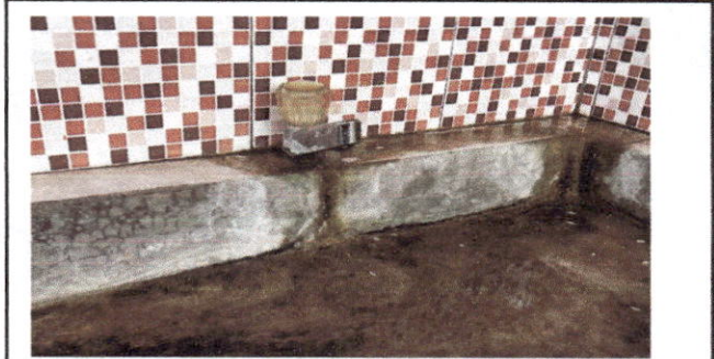
Foto 7: LOS CHORROS DE LOS LAVAMANOS ESTAN VARIADOS EN GRIFOS Y LLAVES, TODOS EN MAL ESTADO Y CON FUGAS.
