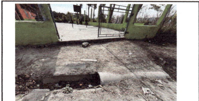
Foto 10: LA RAMPA DE ACCESO PRINCIPAL A LA ESCUELA NO CUENTA CON PISO DE CONCRETO.
