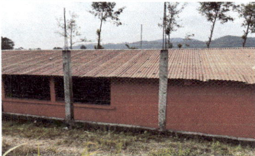
Foto 1: LAMINA GENERAL DEL MODULO, EN MALAS CONDICIONES Y OXIDADA.
