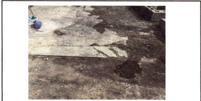
Foto 9: UN SECTOR DE LA CANCHA NO CUENTA CON TORTA DE CONCRETO Y OTRAS AREAS YA ESTAN DAÑADAS.
