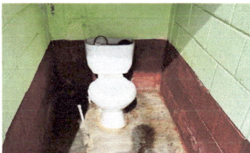
Foto 5: TANQUES DE INODOROS DAÑADOS Y SIN TAPADERAS.
